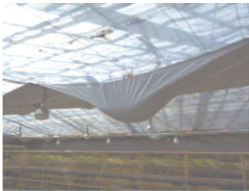
台風 19 号による雨漏り (2019)
