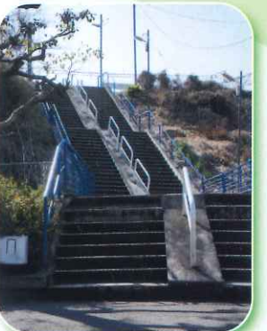
芝山1丁目の東葉高速鉄道そばの階段を緩やかに改良します
